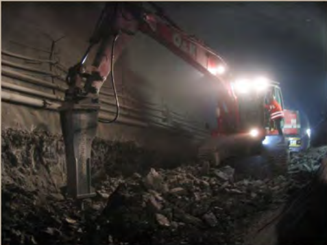
Felsabbruch im Loreley- und Roßsteintunnel
