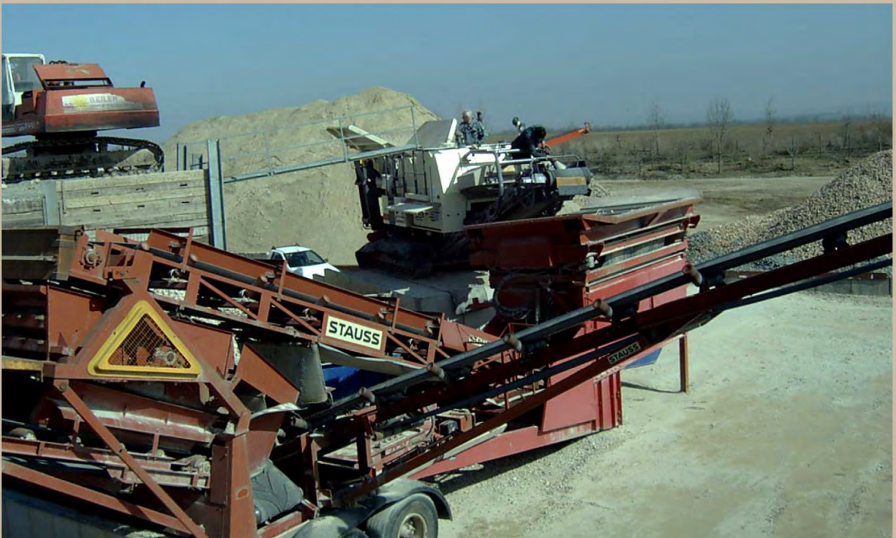
Recyclinganlage in Wörrstadt
