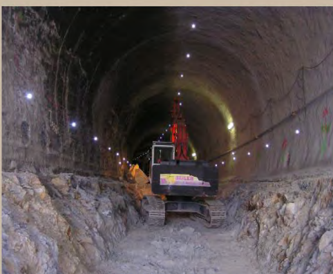
Felsabbruch im Loreley- und Roßteintunnel, St. Goarshausen
